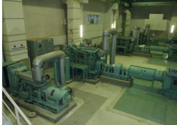
大同川排水機場 機械室全景
