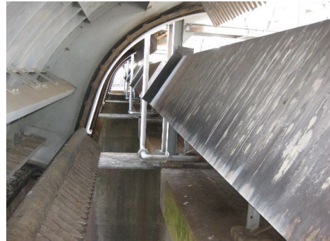
除塵設備 背面
