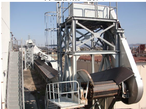
水平コンベヤ ヘッド部
