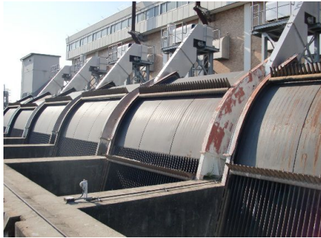
除塵設備 前面
